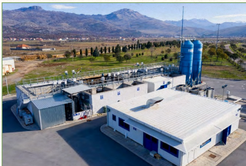
Slika 12: Izgled Pogona za tretman procjednih voda (Izvor Deponija d.o.o.)
